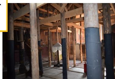
Trotuarul lipit de zidul bisericii împiedică evacuarea umidității
