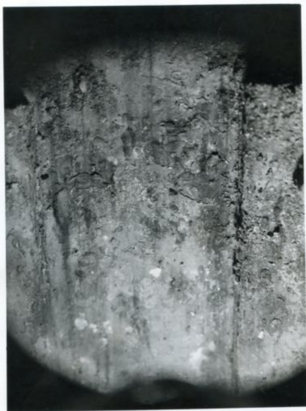
FOTO NR.5 și 6-ASPECTUL SUPRAFETEI NUCLEULUI INTERIOR. SE' OBSERVA EXFOLIERI' PARTIALE ALE VOPSELEI DIN 1937.
